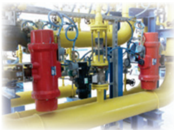
Planta de ciclo combinado (Cartagena, España) Combined cycle cogeneration plant (Cartagena, Spain)
