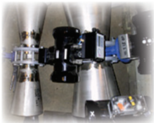
Central eléctrica (Finlandia) Power plant (Finland)
