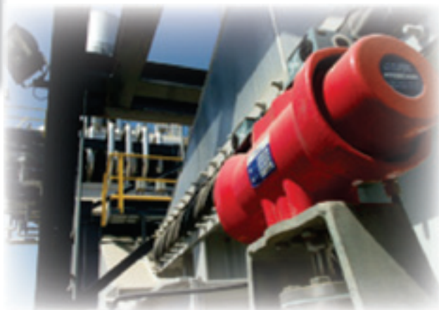
Planta de cogeneración en Motril (Granada, España) Cogeneration plant (Granada, Spain)
